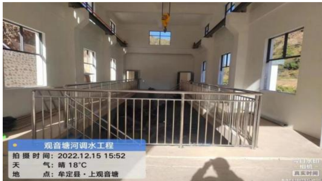
图 2 一级泵站机组间
